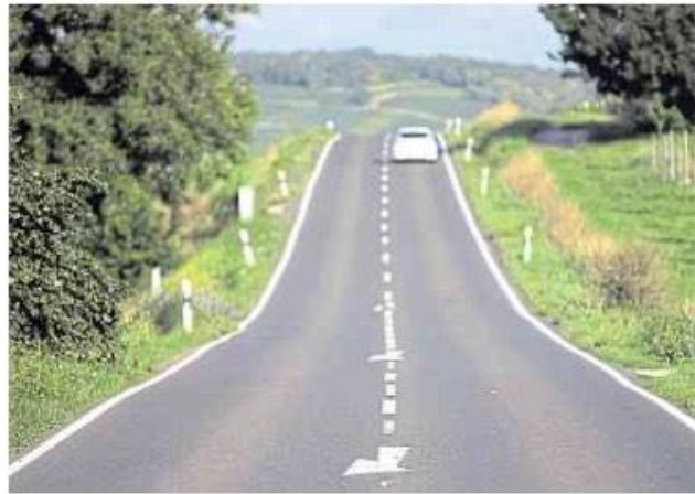
Längst nicht alle Straßen in Rheinland-Pfalz sind in einem solchen guten Zustand wie diese in Elsheim (Kreis Mainz-Bingen). Mit neu eingestellten Ingenieuren soll der Sanierungstau jetzt abgearbeitet werden. Foto: dpa
